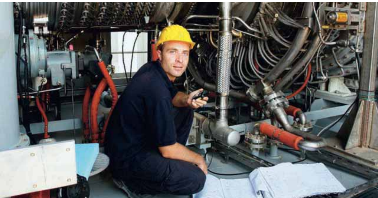
Exploitation de la cogénération d'Ashkelon. Israël.
