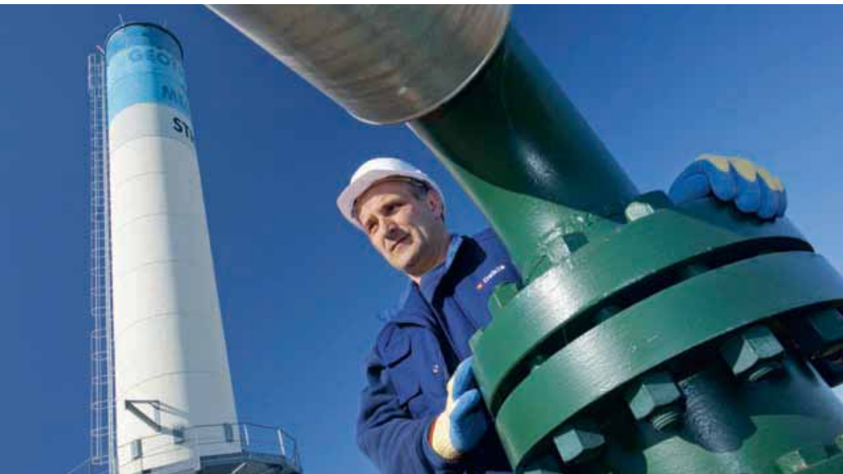
Géothermie à Melun. France.
