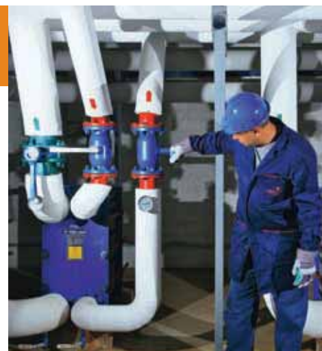
Centrale du réseau de chaleur de Ploiesti. Roumanie.
