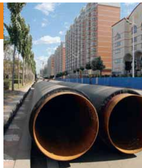
Réseau de chaleur de Harbin, Chine.
