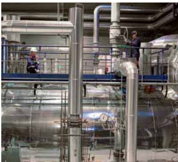
Centrale de cogénération à Strasbourg, France.
